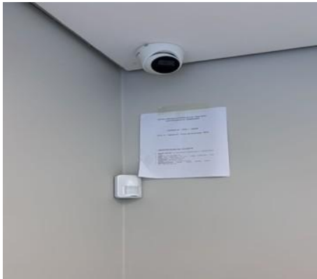
Figura 9 – Câmera Dome de videomonitoramento em operação durante a PoC
