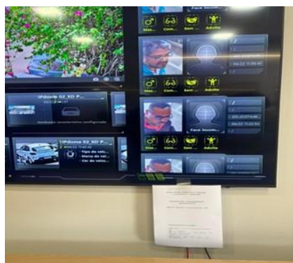
Figura 1 – Central de videomonitoramento instalada para teste
