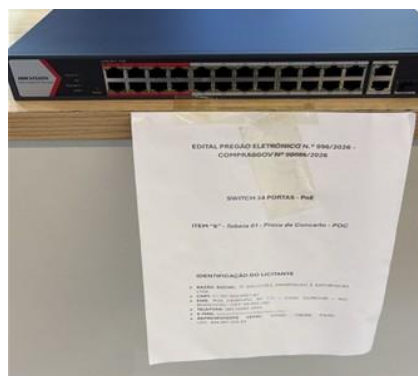
Figura 2 – Switch de rede utilizado na interligação das câmeras
