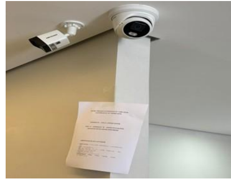
Figura 6 – Câmera Dome de videomonitoramento em operação durante a PoC
